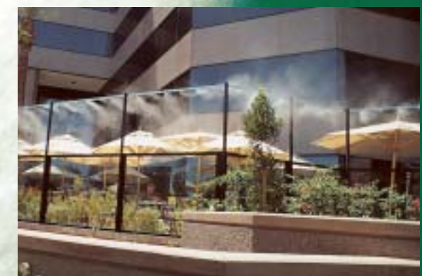
Refrigeración de exteriores
